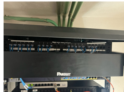
Infraestructura de Red
