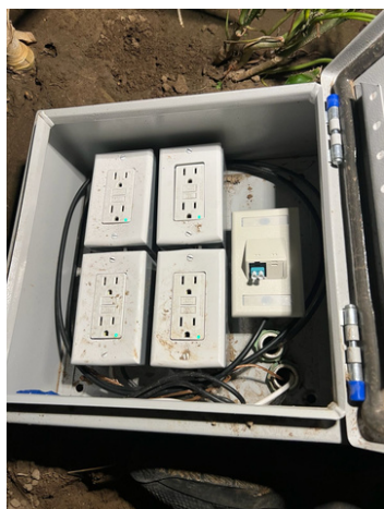
Distribución de Fibra Óptica
