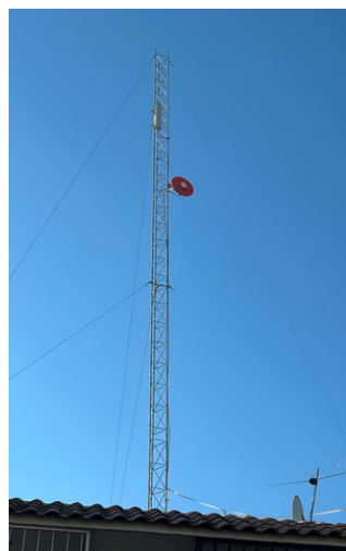
Torre de Telecomunicaciones
