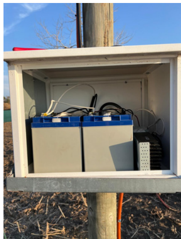
Banco de Baterías
