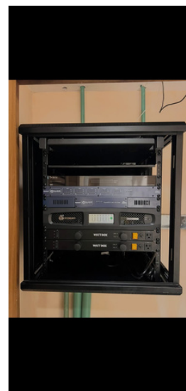
Rack de Audio y Control
